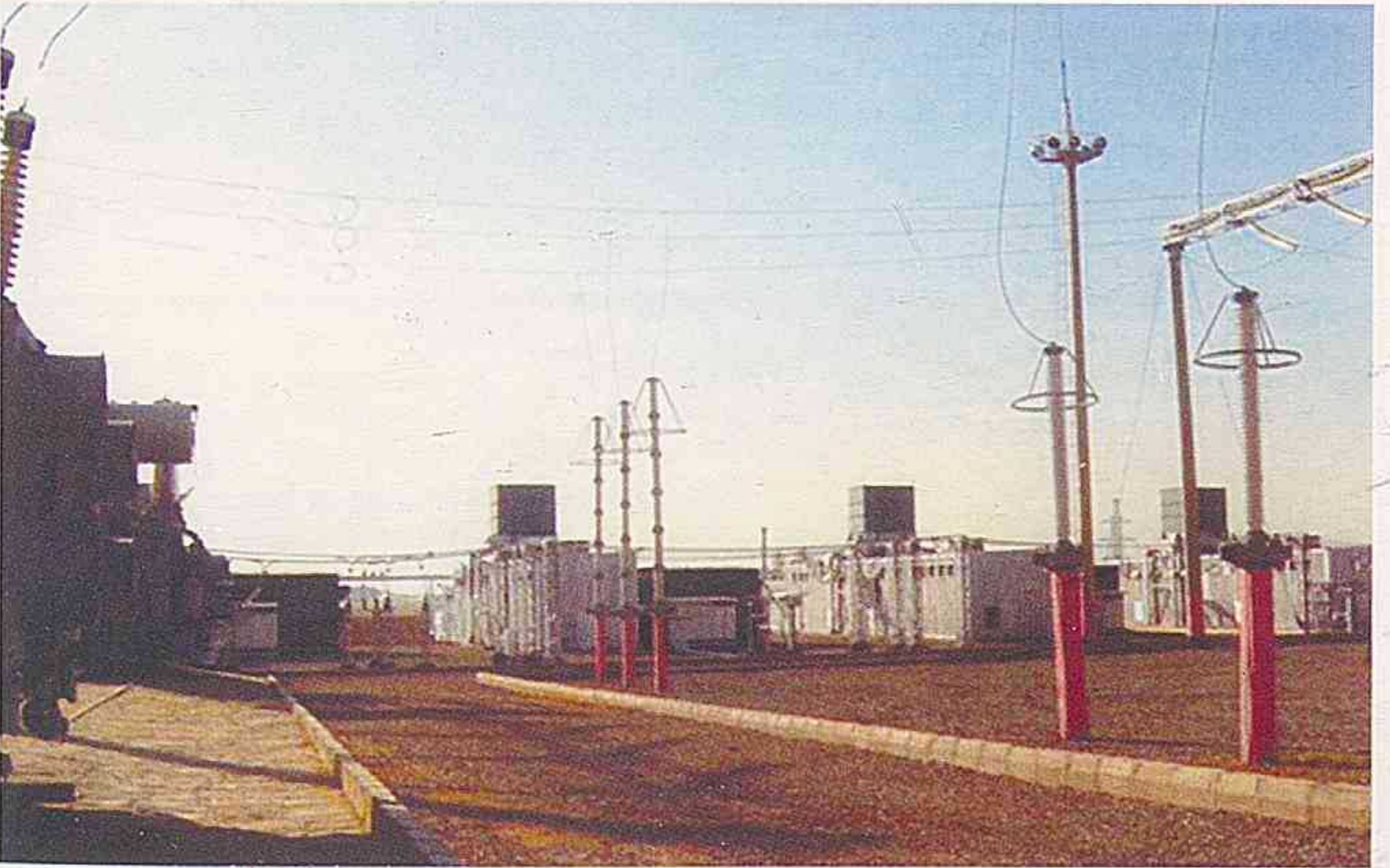
60 mVt gücündə Naxçivan Qaz Turbin Elektrik Stansiyası
