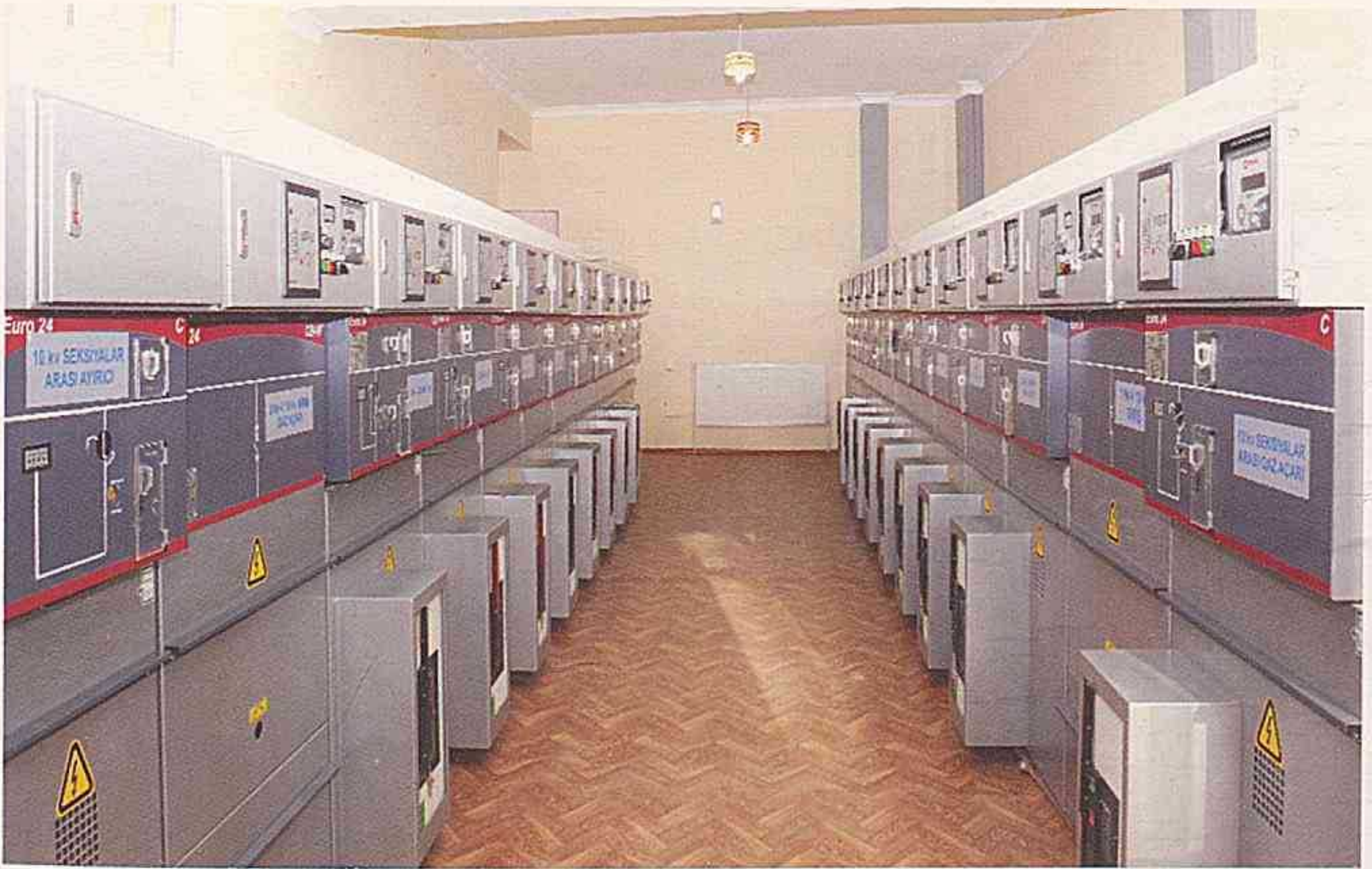
Naxçivan şəhərində 110/35/10 kilovoltluq "Naxçivan" elektrik yarımstansiyası
