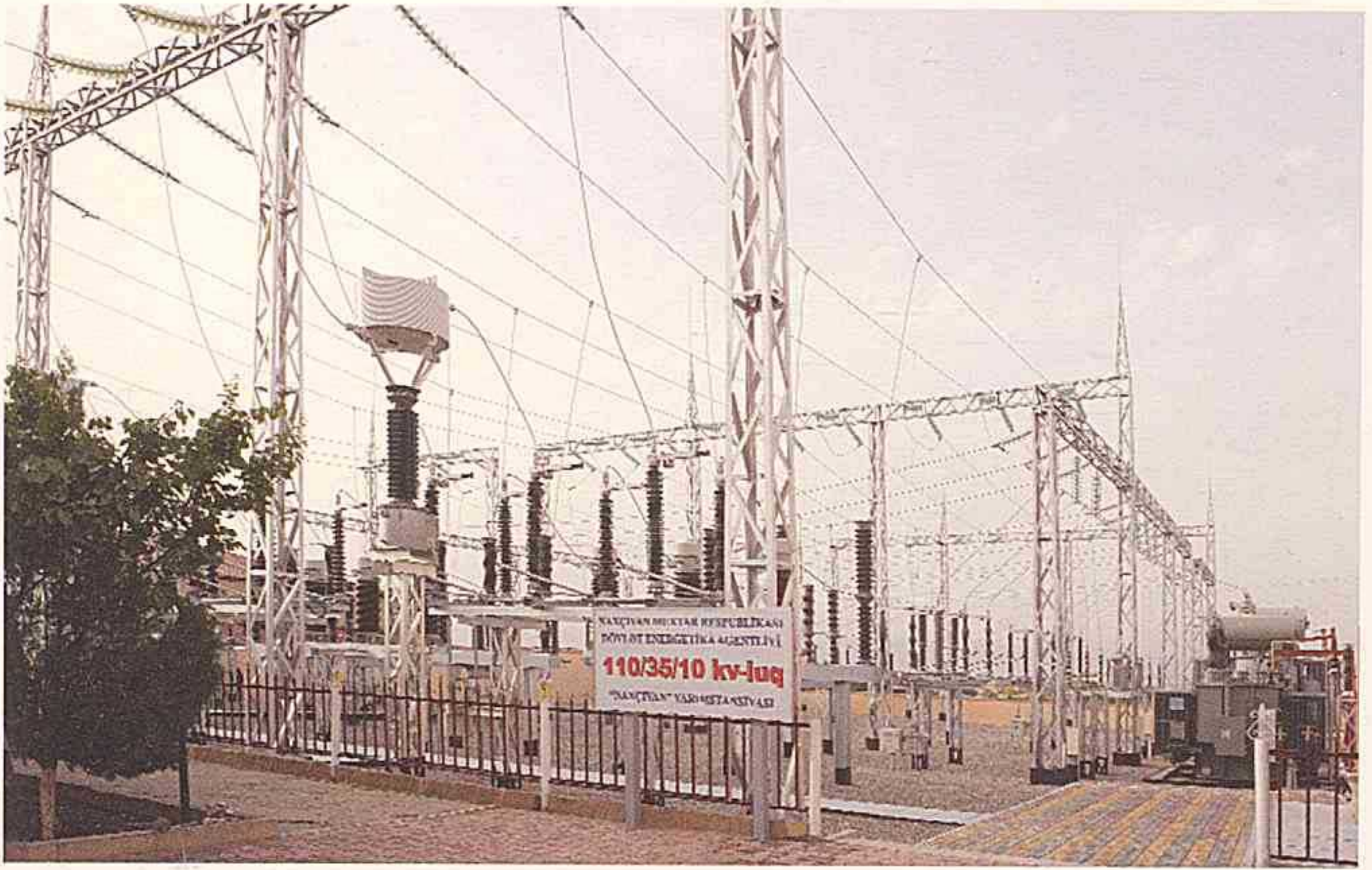
Naxçivan şəhərində 110/35/10 kilovoltluq "Naxçivan" elektrik yarımstansiyası
