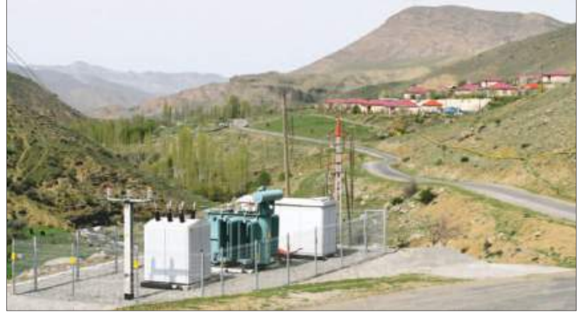
Şahbuz rayonunun Külüs kəndi ərazisində 2500 KVA gücündə 35/10 kilovoltluq transformator yarımstansiyası
