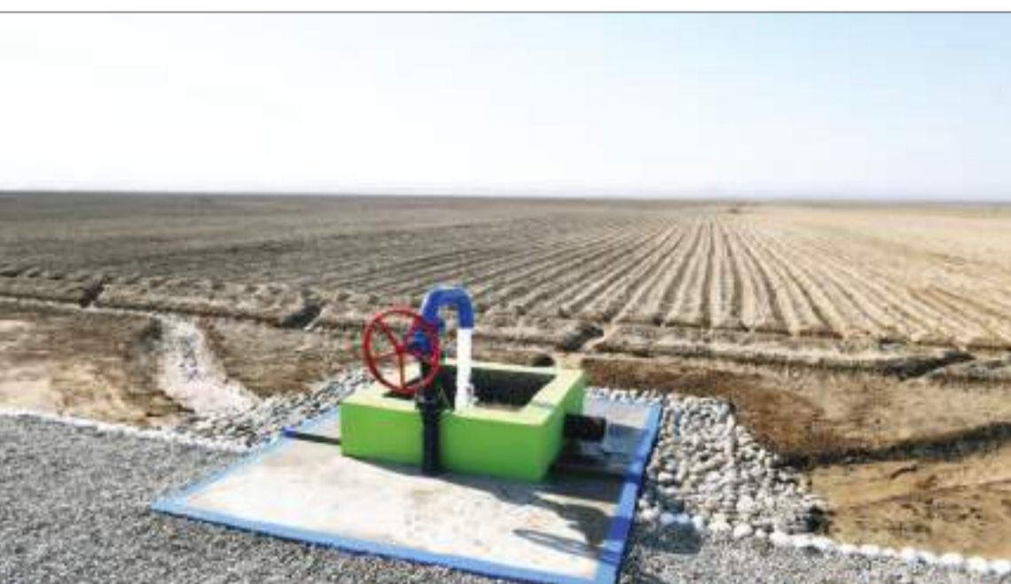
Kəngərli rayonunun Böyükdüz kəndi ərazisində 363,4 hektar sahəni əhatə edən qaralı suvarma şəbəkəsi
