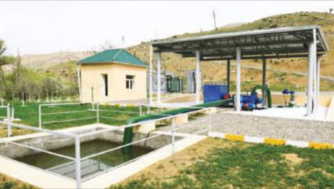
Şahbuz rayonunun Külüs kəndində nasos stansiyası
